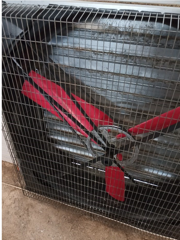
8. ábra: A jelenlegi ventilátor
