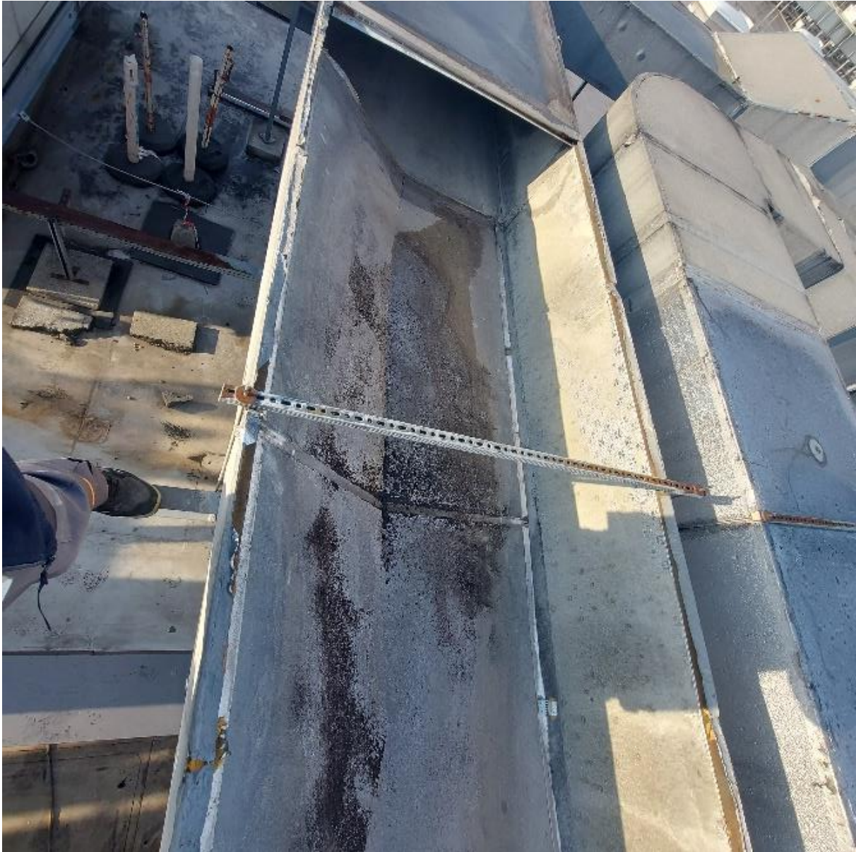
3 ábra Korrodált, beszakadt légszatórna
