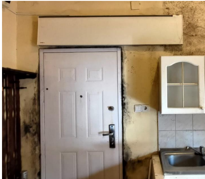
27. ábra A nem hőszigetelt bejárati ajtó, felette az elektromos fűtőtest (forrás: saját fotó)
