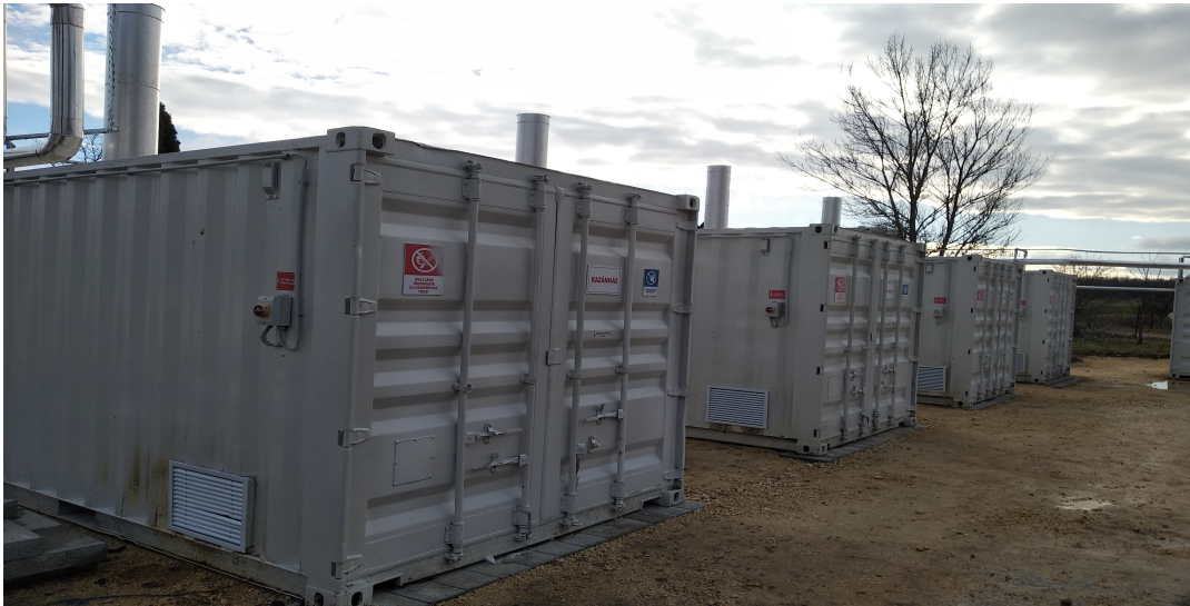
18. ábra telepített konténerkazánok (saját fotó)
