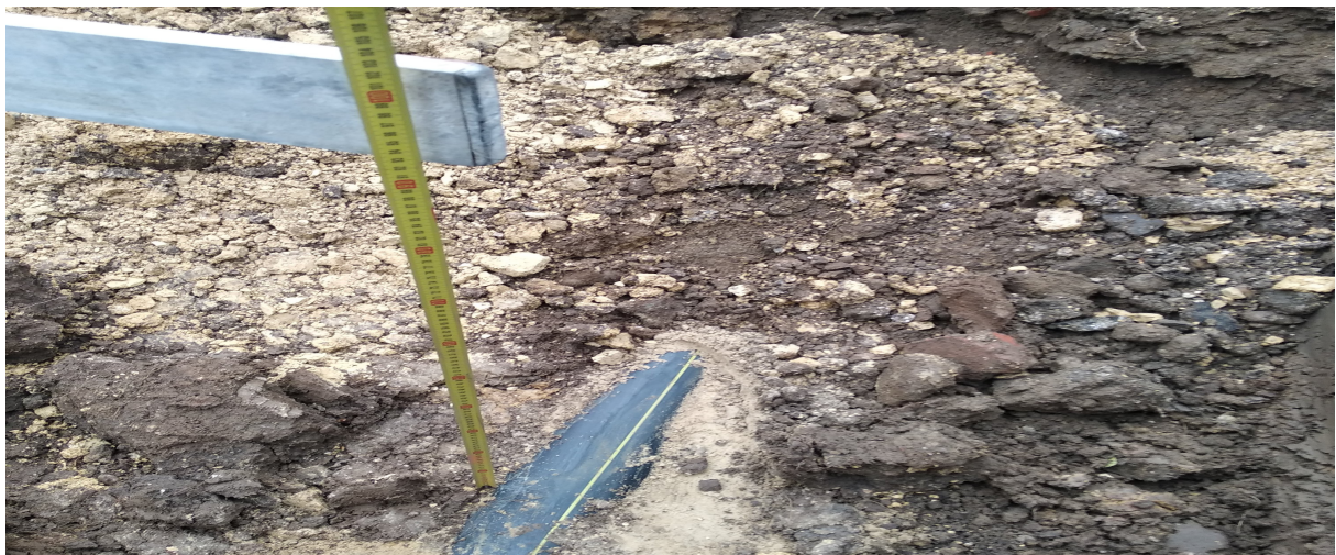
20. ábra földmunka alkalmával megtalált gázvezeték
