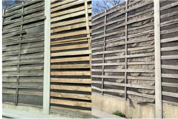
4. ábra Fafonatos zajárnyékoló falak M7 autópálya Sukoró környékén (Forrás: saját kép 2024.03.15)
