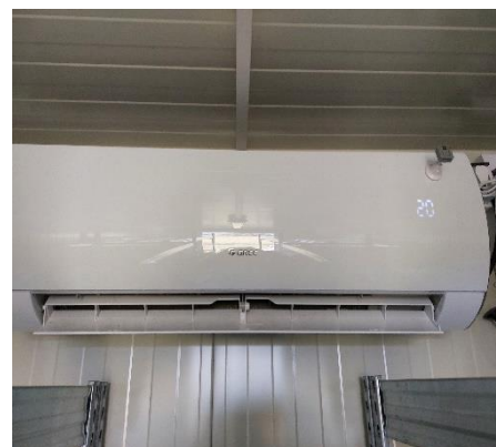
kép 17: A klímaberendezkedés a konténeren belül
