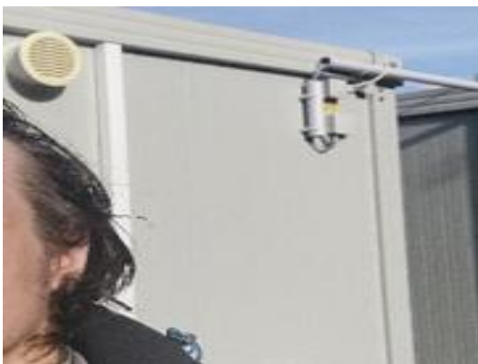
kép16: A klímaberendezés külső szellőzője, és az áramvezeték a konténeren.
