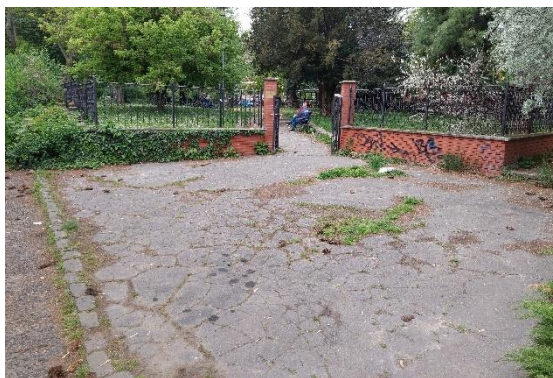
43.ábra: Töredezett aszfalt burkolat (Saját készítésű fotó)
