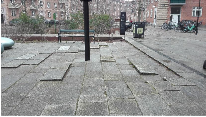
2. melléklet: Tåsinge tér, burkolat süllyesztéssel vezetett csapadékvíz (Forrás: Saját fénykép, 2023)
