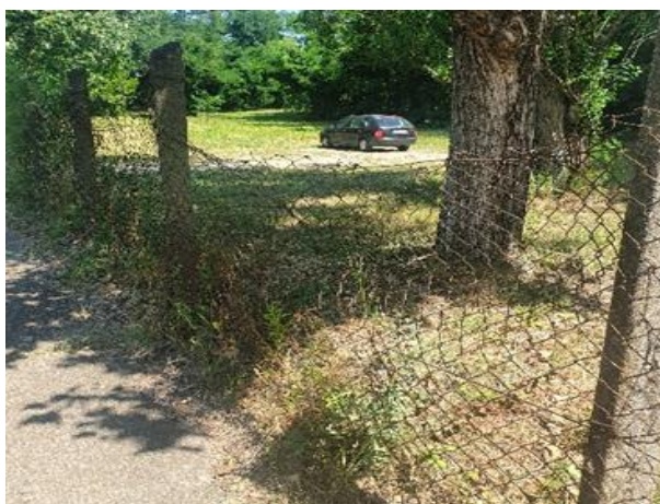
46. Melléklet: Kerítés nem megfelelő állapota (saját kép)
