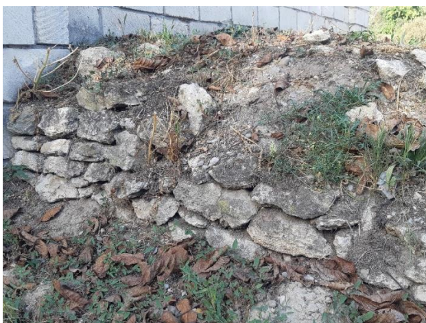
45.ábra: Durva mészkő leromlott állapotú szárazon rakott támfal forrás: Saját kép
