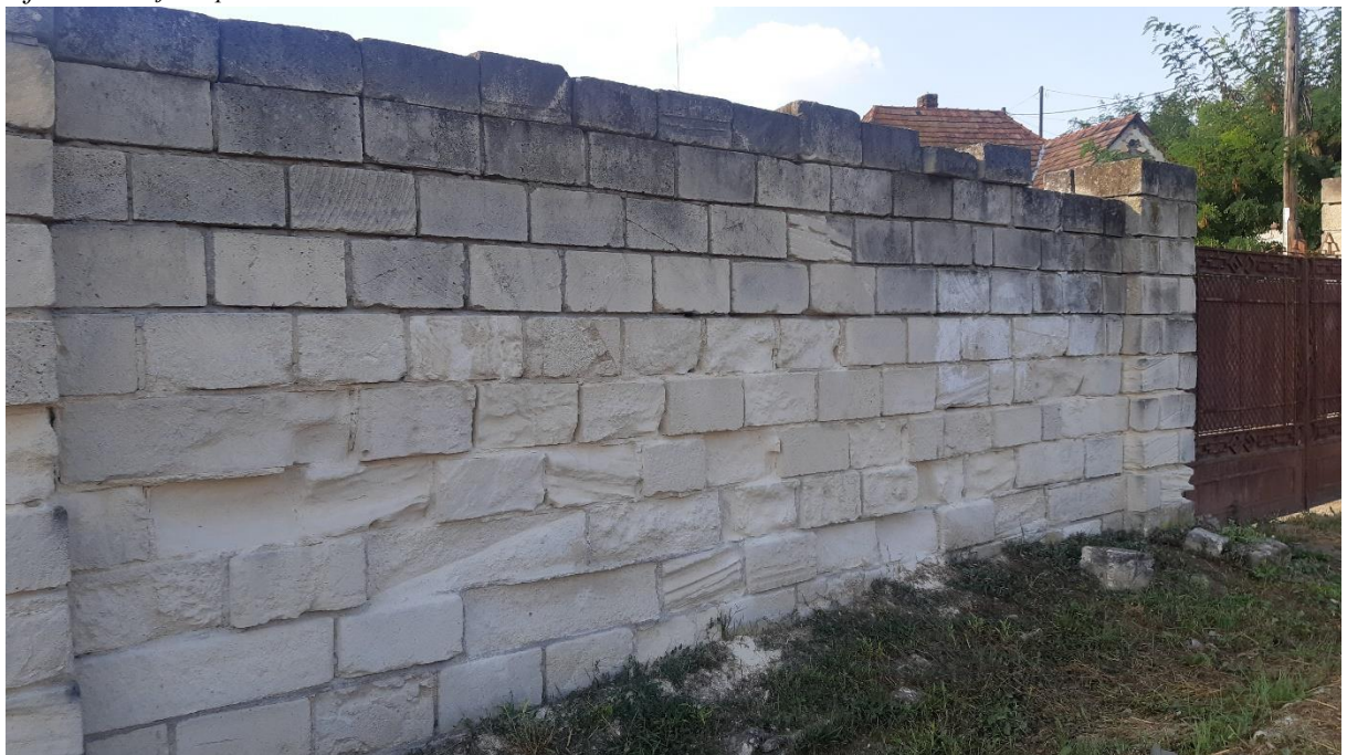
60.ábra: Durva mészkő kerítés leromlott állapot Tárnok forrás: Saját kép
