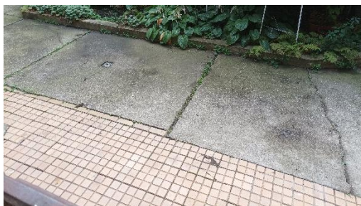
35. ábra Rózsa utca 74. Burkolat (Saját fotó)
