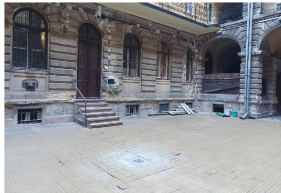
10. Melléklet Víznyelő az udvar közepén (Saját fotó)
