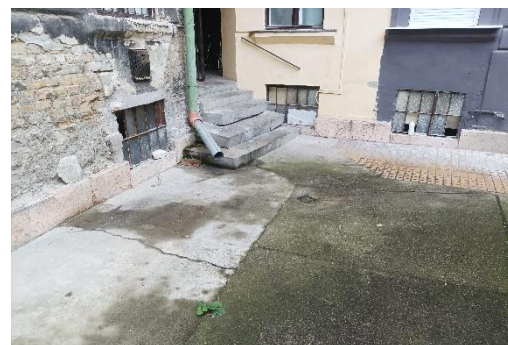
37. ábra Rózsa utca 74., Ereszcatorna (Saját készítésű fotó)
