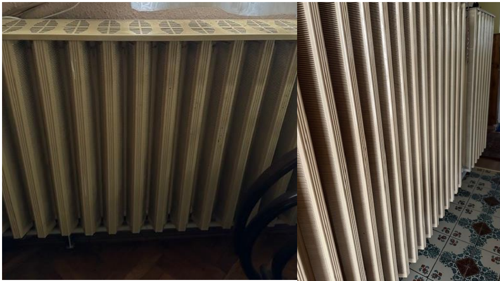
16. ábra Hőleadók az épületben (Forrás: saját készítésű fotó)
