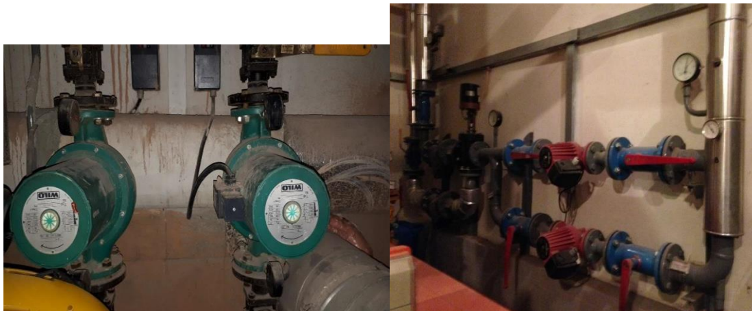
25. ábra: Kazánfűtés keringető szivattyúi
