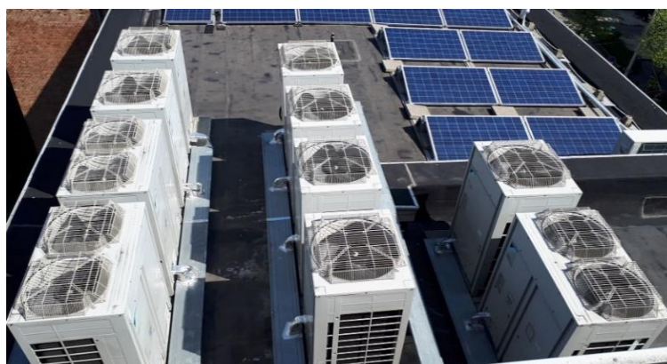
27. ábra: Tetőn elhelyezett VRV rendszer kültéri modulok
