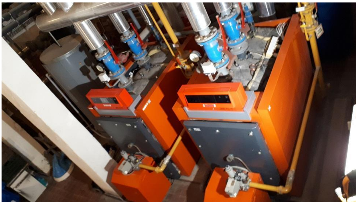
23. ábra: Viessmann kazánok és a HMV tároló
