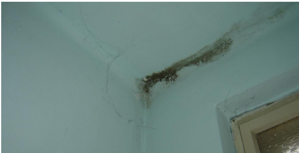
7. ábra: Hőhíd okozta penészesedés (Forrás: saját ábra)
