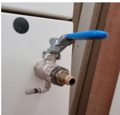
16. ábra: Lelakatholható sűrített levegő főelzáró csap (saját fotó)
