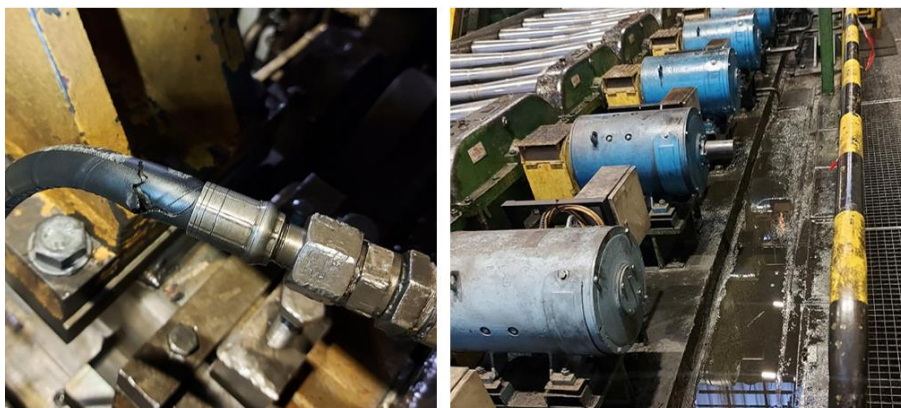
26.ábra: Tömlőszakadás és az abból fakadó olajszenyezés. [saját fénykép]
