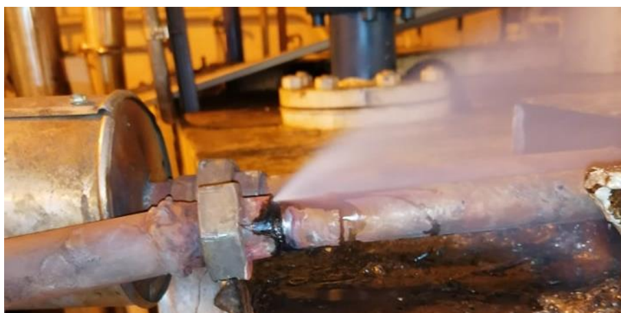
35.ábra: ZS7 fűtés-cső törés. [saját fénykép]
