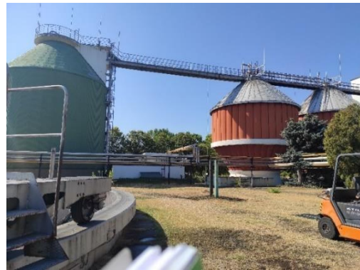
21. ábra: Rothasztótornyok (Forrás: saját fotó)
