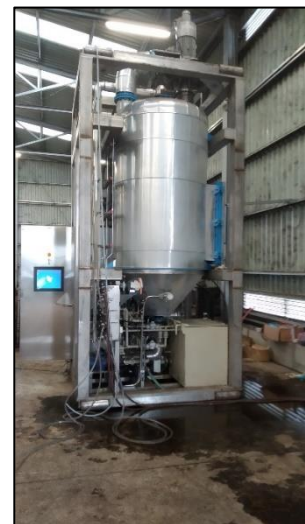
15. ábra A bepárló berendezés (Forrás: A prototípus technológiák integrálása a szennyvíztisztító telepen dokumentációból)
