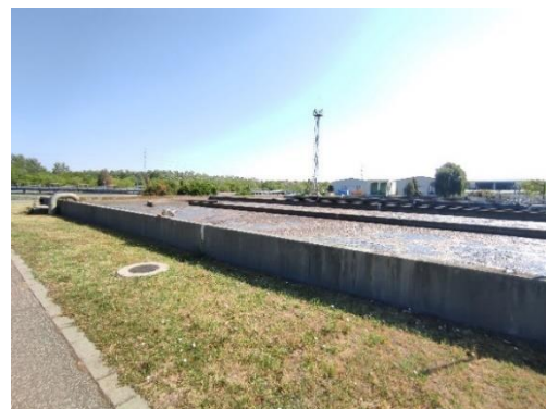
19. ábra: Levegőztető medencék (Forrás: saját fotó)
