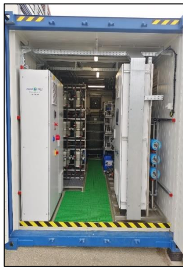
14. ábra A FO-RO technológia konténere (Forrás: A prototípus technológiák integrálása a szennyvíztisztító telepen dokumentációból)
