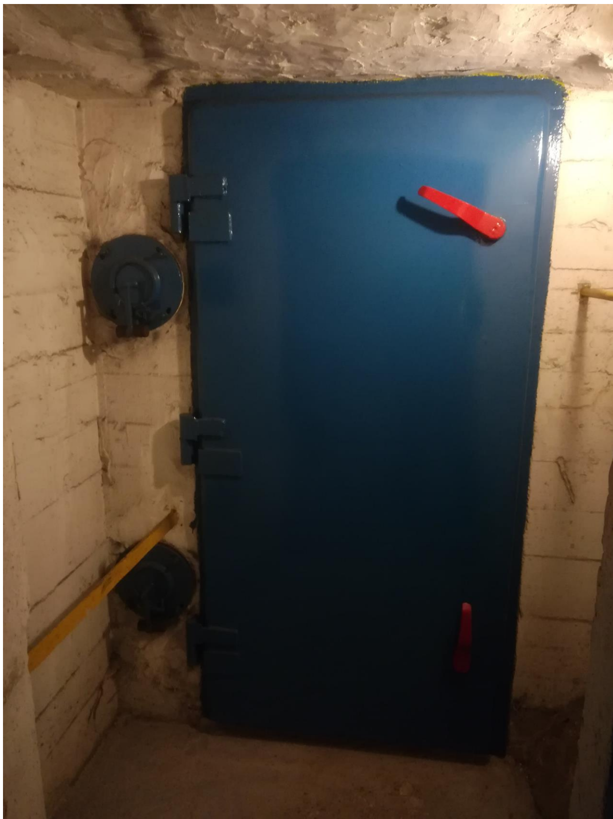
2. melléklet: Ferenciek tere metróállomáson egy GLA ajtó, mellette vízszintes beépítésű, ellensúlyterhelésű KID szelepek. Szerző saját felvétele 2019.12.07-én.
