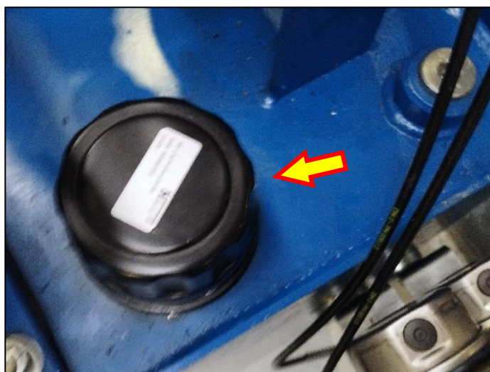
20. ábra – Azonosítatlan töltési hely a hidraulika tartályon [saját készítés]
