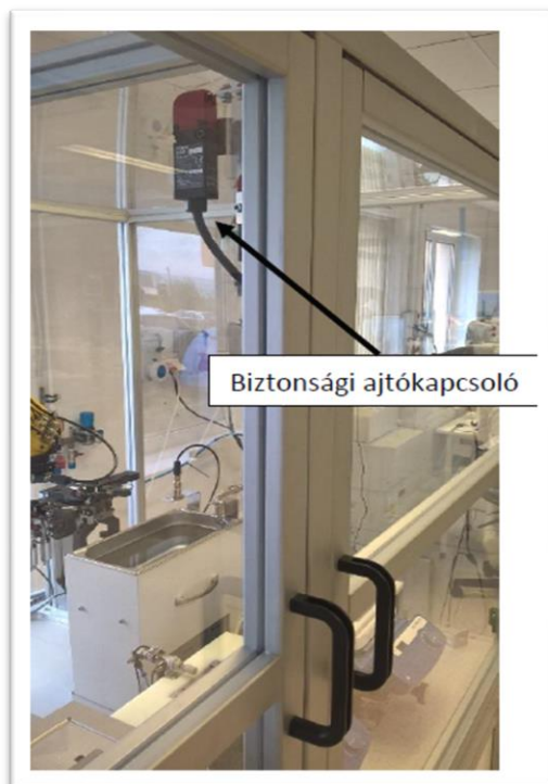
20. kép: Ajtó biztonsági kapcsoló (forrás : saját fotó)
