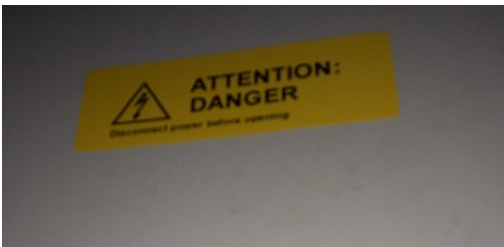
10. kép: Áramütés veszélyére való figyelmeztetés. Forrás: Saját kép
