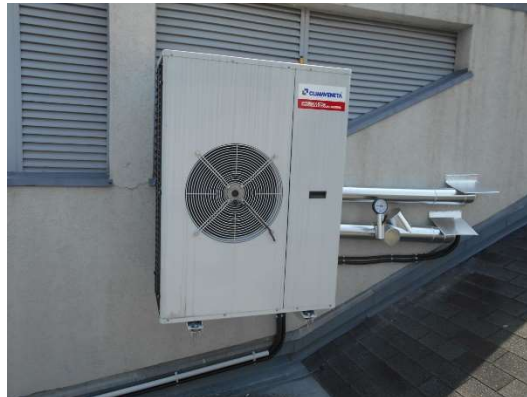
32. ábra Mitsubishi i-BXN/008M hőszivattyú HMV igény kiszolgálására
