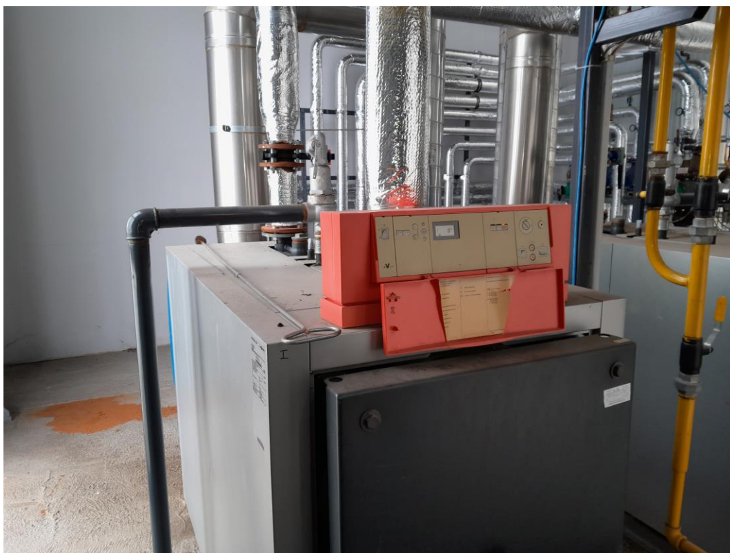
9.ábra: A tetőfelépítményben kaszkádban elhelyezett gázkazánok
