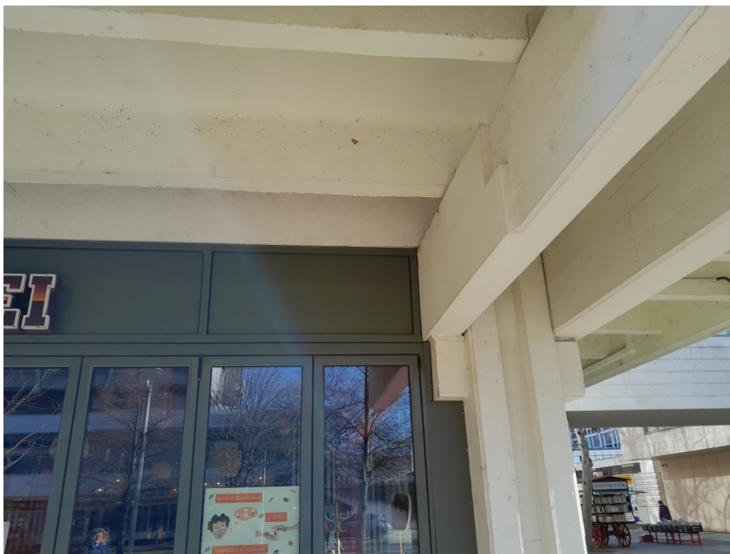
6.ábra: A vasbeton szerkezetek utólagos hőszigetelésére nem volt lehetőség, a fűrendelt tartók és a T-panelek hőszigetelés nélkül kialakítva rendkívül hőhidak
