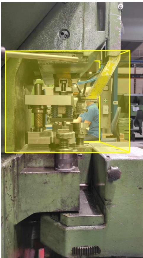
21. ábra Kónuszos excenter prégépen az oldalirányból nyitott munkatér veszélyének elhárítása (forrás: saját szerkesztés)
