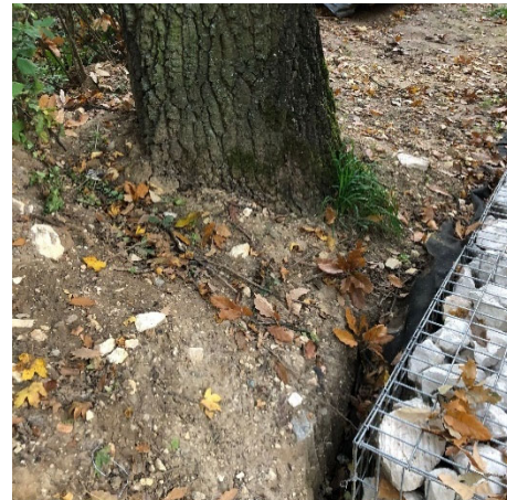
16. ábra: Gabion támfal építése okozta gyökérsérülés a 2. sz fánál (saját felvétel, 2022. október)
