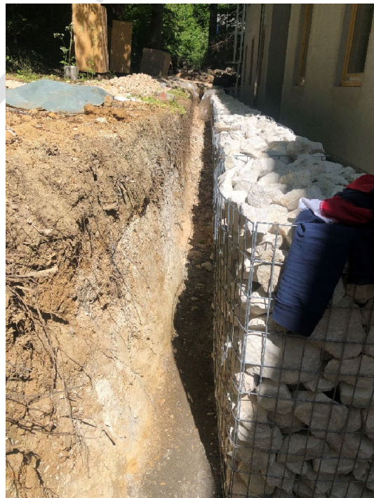
12. ábra: Gabion támfal építés közben okozott gyökérsérülések (saját felvétel, 2022.május)
