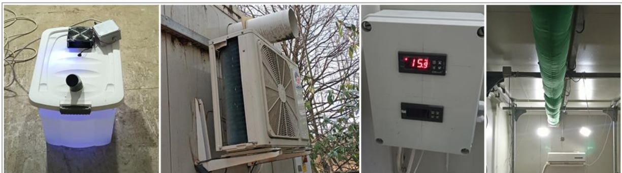
2. ábra: A párásító, a klíma külső egysége és a szellőztető kivezetése, a digitális termosztát és páramérő, a szellőztető textil légcsatornája (Forrás: saját fényképek)
