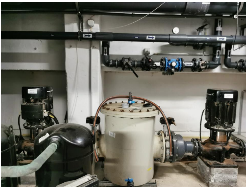
12. ábra: A két, párhuzamosan telepített forgatószivattyú. A szemközti fal mögött található a puffertároló, ahonnan érkezik a középen látható durvaszűrőbe a forgatandó medencevíz. Innen megy tovább párhuzamosan a két szivattyúba. Saját kép
