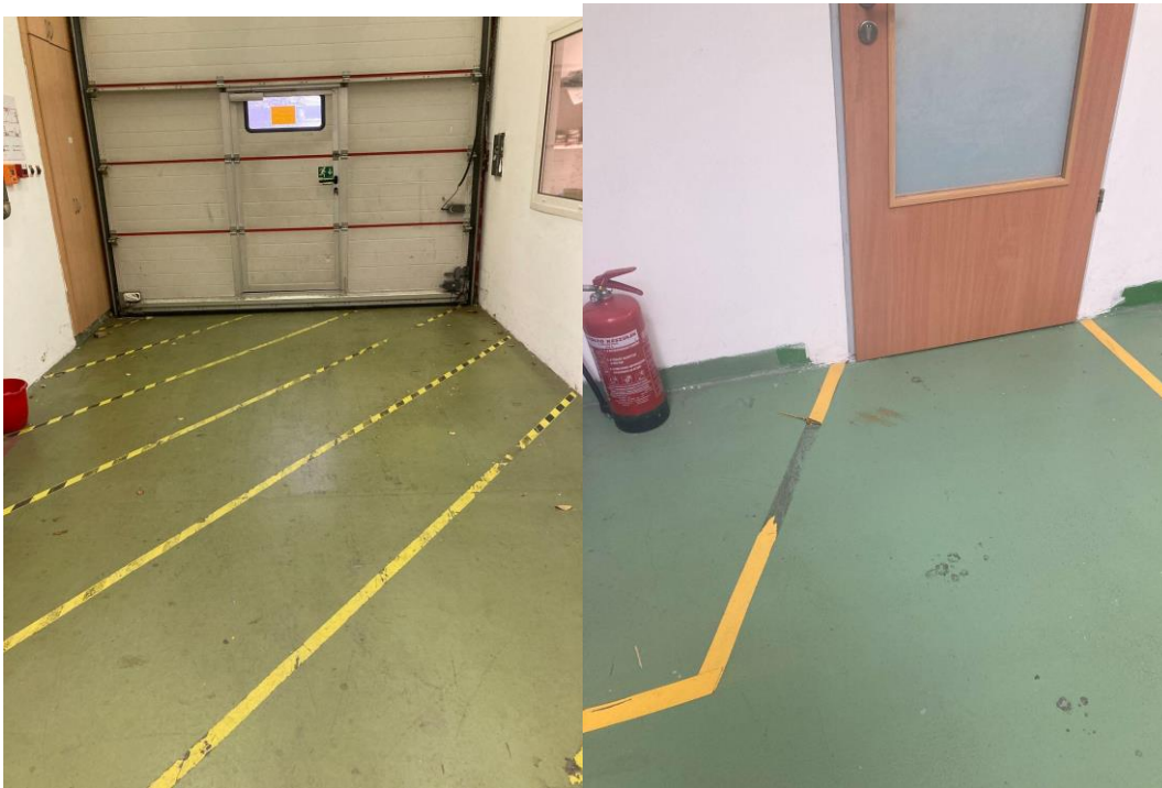
Ábra 13 Hiányosságok a padlójelöléseknél, forrás: Saját készítés
