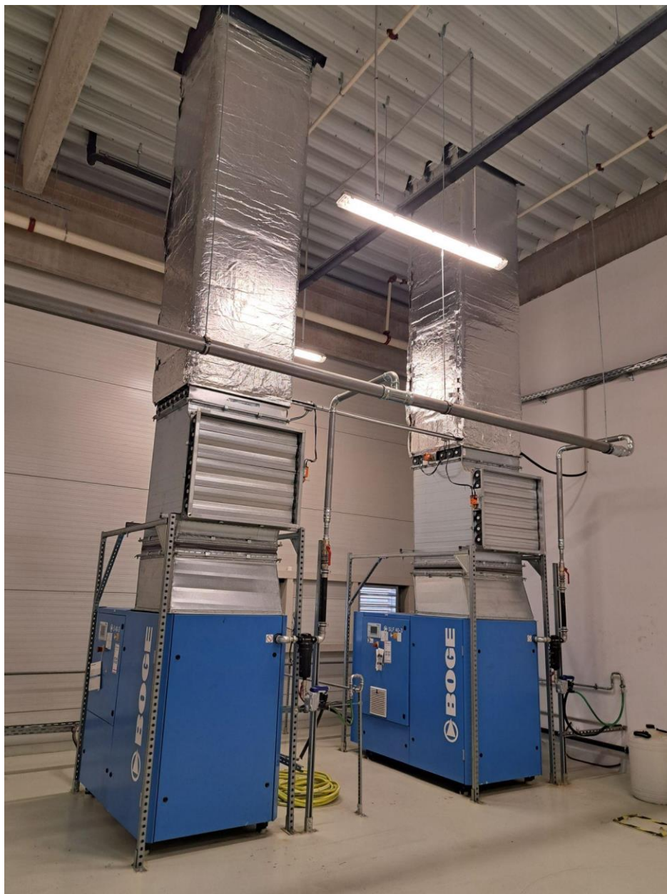
27. ábra: 2. sz. gépház kompresszorai
