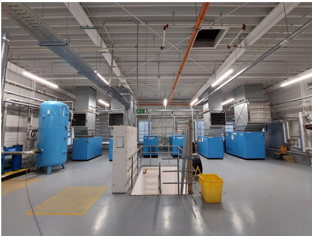
16. ábra: 1. számú kompresszor gépház
