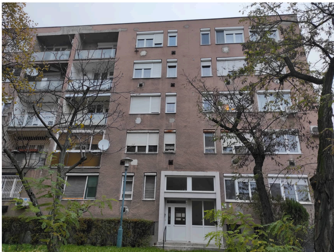
15. ábra: Javított homlokzat a legfelső szinten
