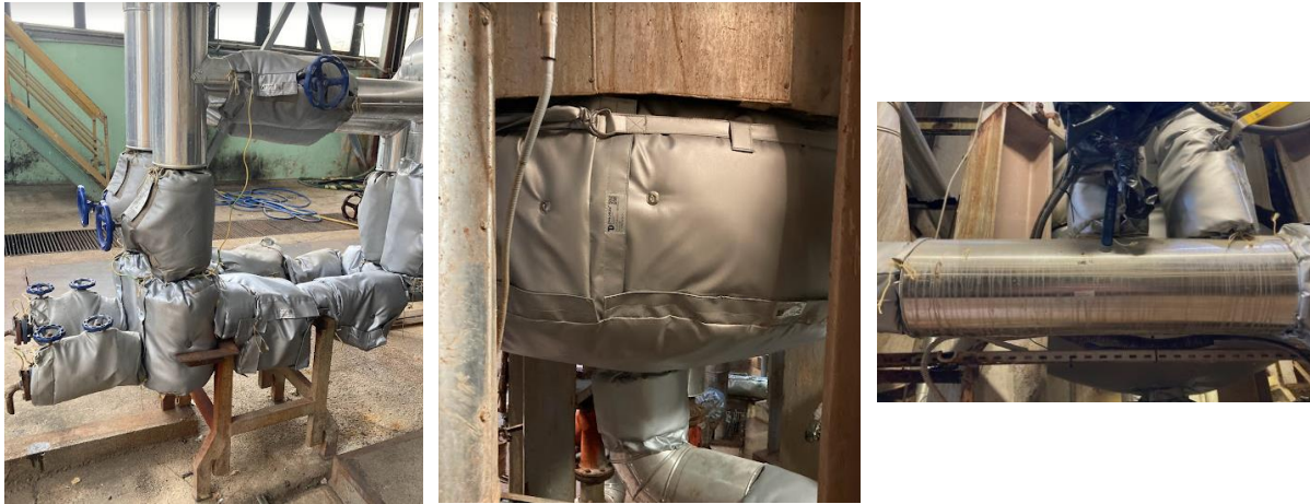
14. ábra: A szigetelt szerelvények, tartály alj és kondenzvíz csővezeték (Forrás: Saját fényképek).
