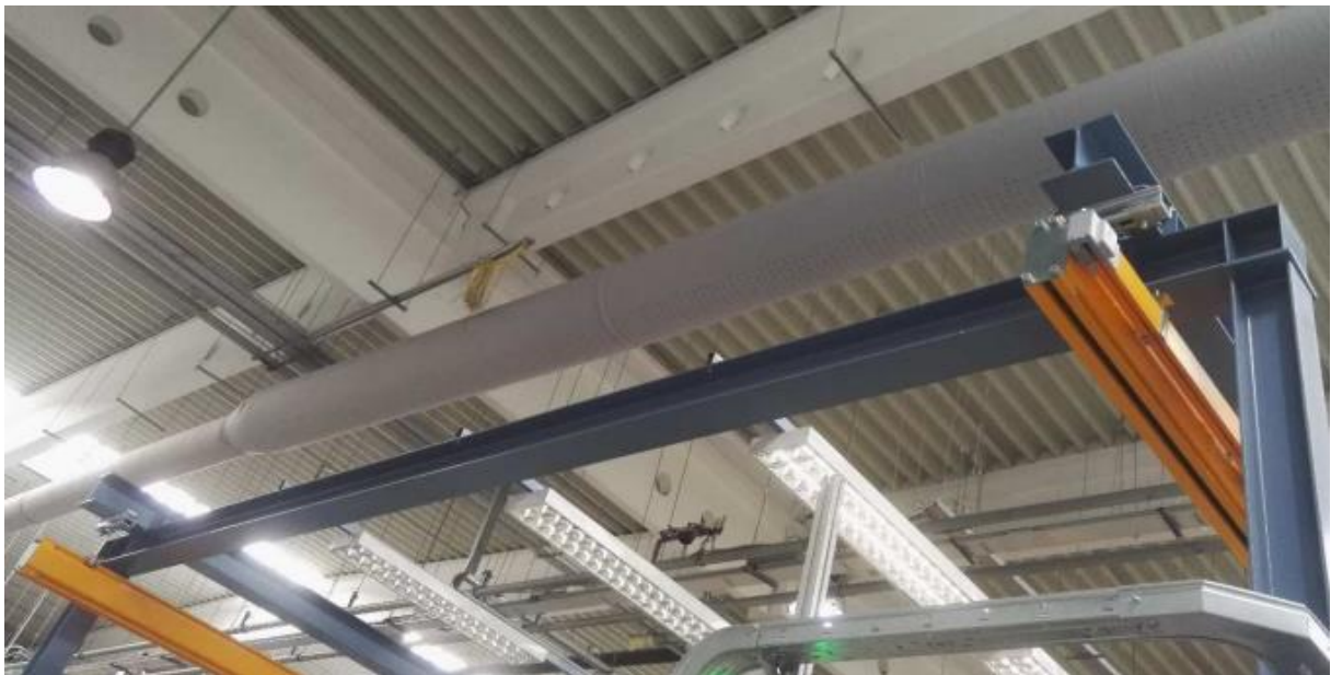
4.1. ábra újonnan kiépített textil légcsatorna ág [saját fotó]
