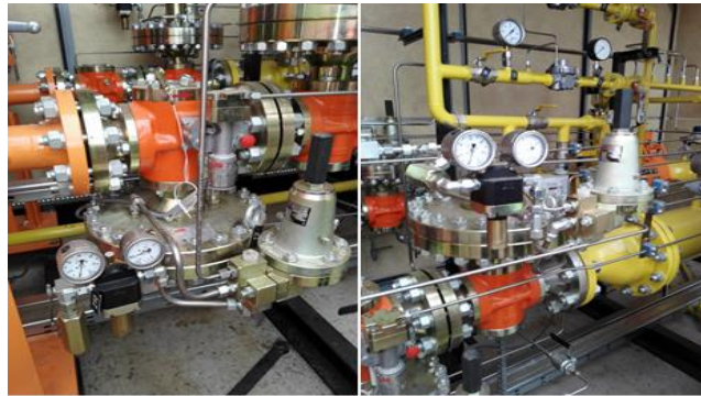
5. ábra Gázfogadó állomás
