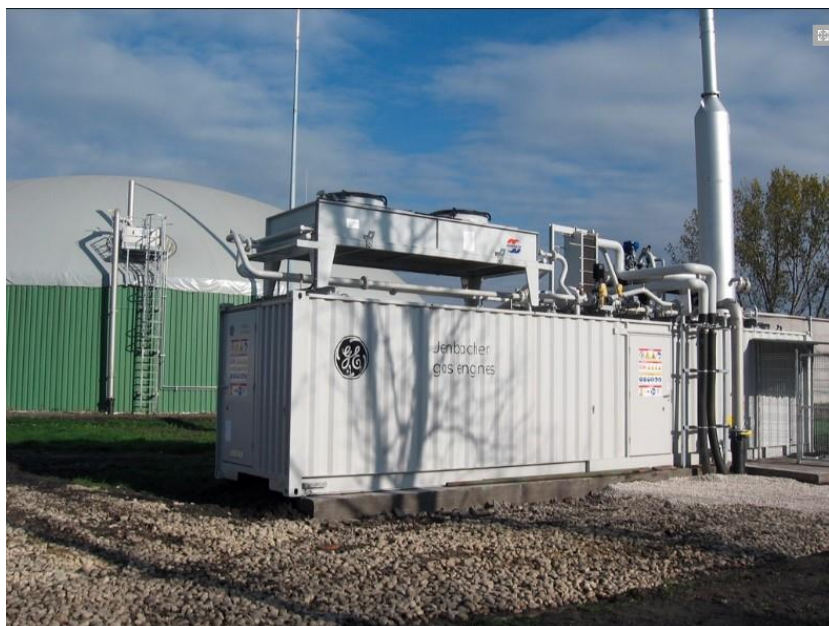
13. ábra Biogáz felhasználás GE-Jenbacher gázturbinában elégetve (forrás Stallprofi.hu)
