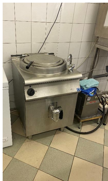
6. ábra Hőkezelő berendezés
