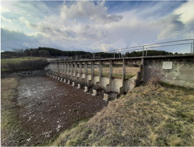
15.Melléklet: Víztorozó felújítandó zsilipje – Saját készítésű fotó
