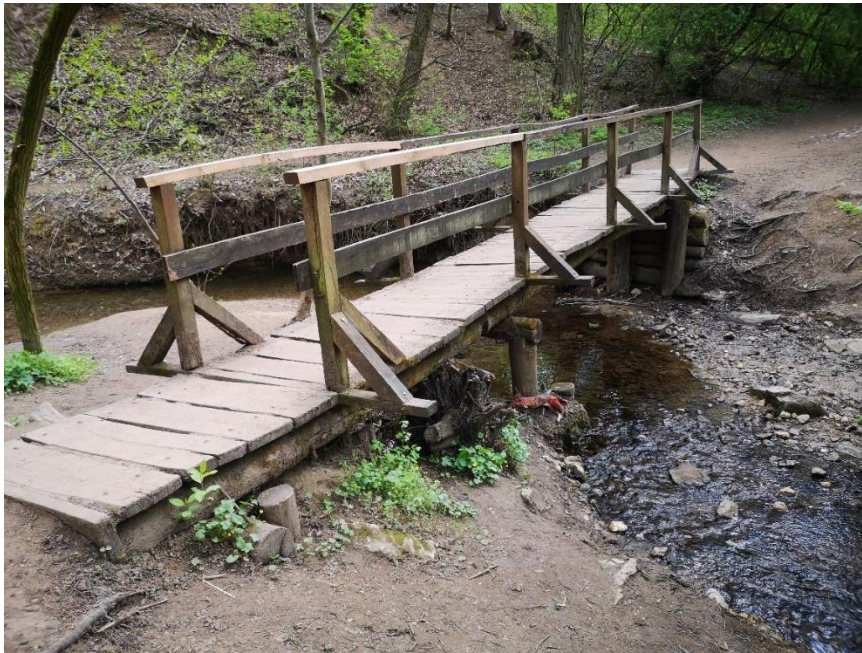
5. számú fénykép: A Paprikás-patak fölött átívelő híd alatt található partszakasz alámosottsága
