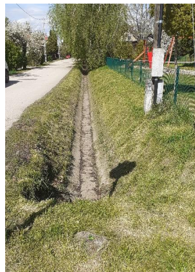
63. ábra: Felszíni csapadékvíz elvezetésre javaslat (fotó az Otthon utcáról) (forrás: saját fotó)
