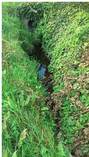
22. melléklet: Vízfolyás a Pannónia utcában. (saját fotó)
