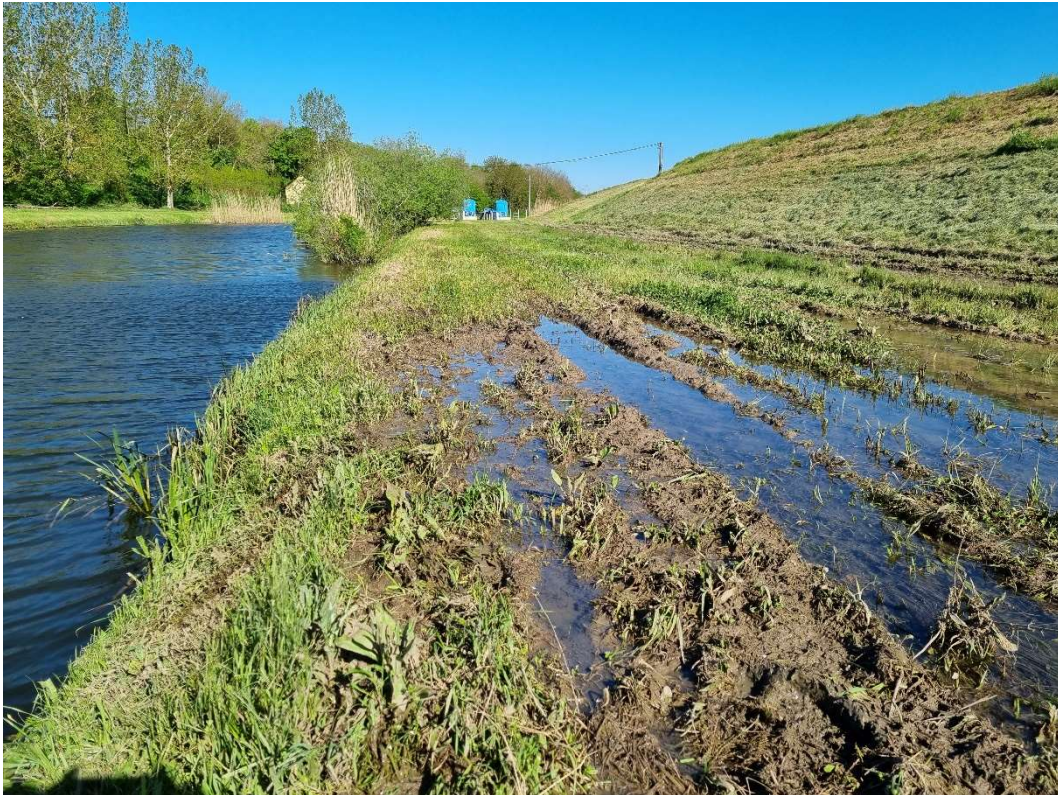
11. ábra A víztározó melletti vízszivárgás, Fotó: Maczkó Norbert, 2023
