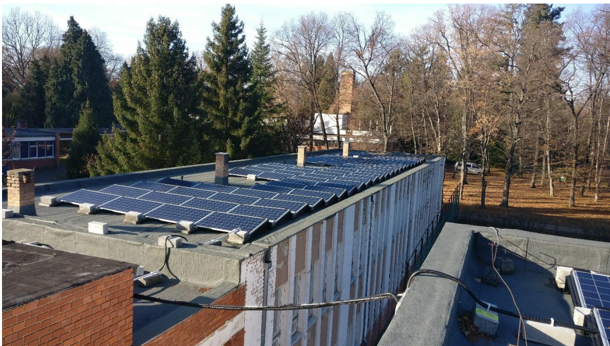
6. ábra: A tanügyi épület napelem paneljeinek egy része (Forrás: A képet az iskola gondnokság vezetője készítette)
