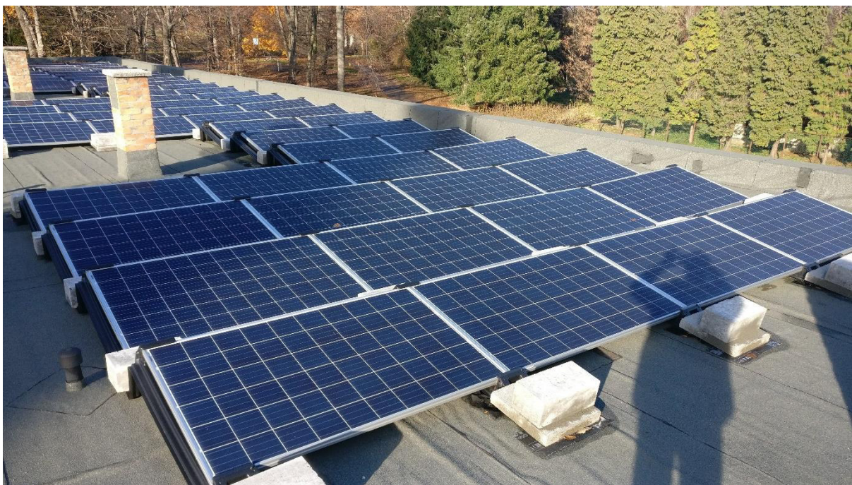
7. ábra: A tanügyi épület napelem paneljeinek egy része (Forrás: A képet az iskola gondnokság vezetője készítette)
