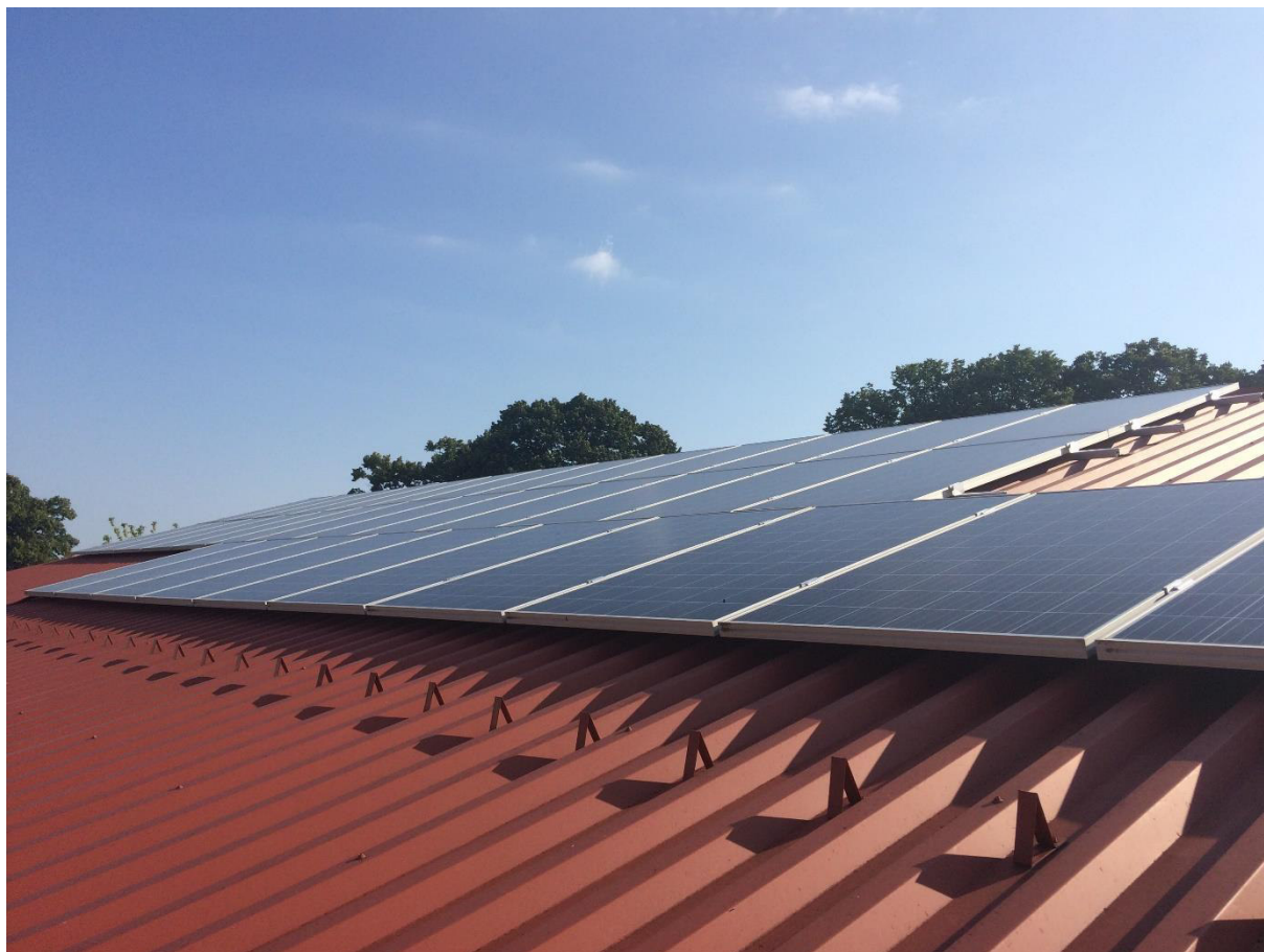
8. ábra: A tangazdaságban elhelyezett napelemek (Forrás: A képet az iskola gondnokság vezetője készítette)
