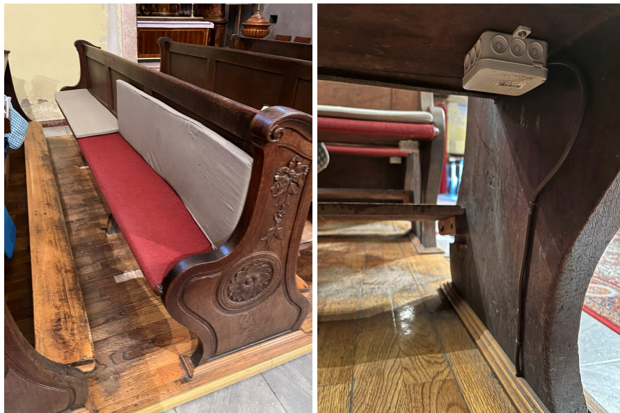
16. ábra – Padfűtés a tatai templomban (Forrás: saját felvétel)
