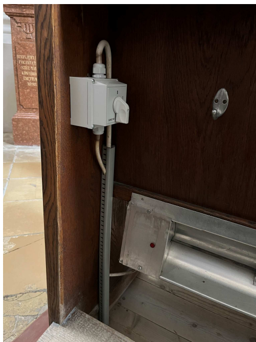
37. ábra–Nyergesújfalui Szent Mihály templom padfűtése kialakítása, kapcsolója (Forrás: saját felvétel, 2023)
