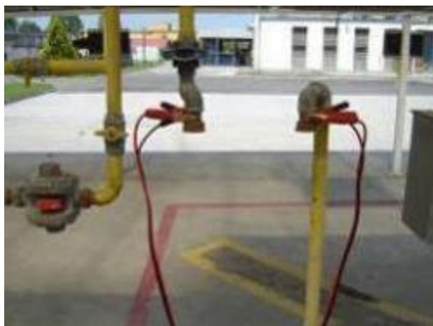
4. ábra Leszerelt mérő helye (MVM Főgáz Földgázhálózati Kft. G-TU-04, 2022)
