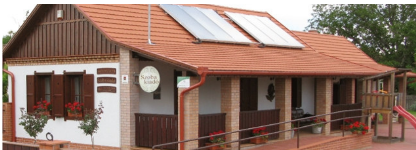
15. ábra: A napelemek a vendégház tetőszerkezetén
