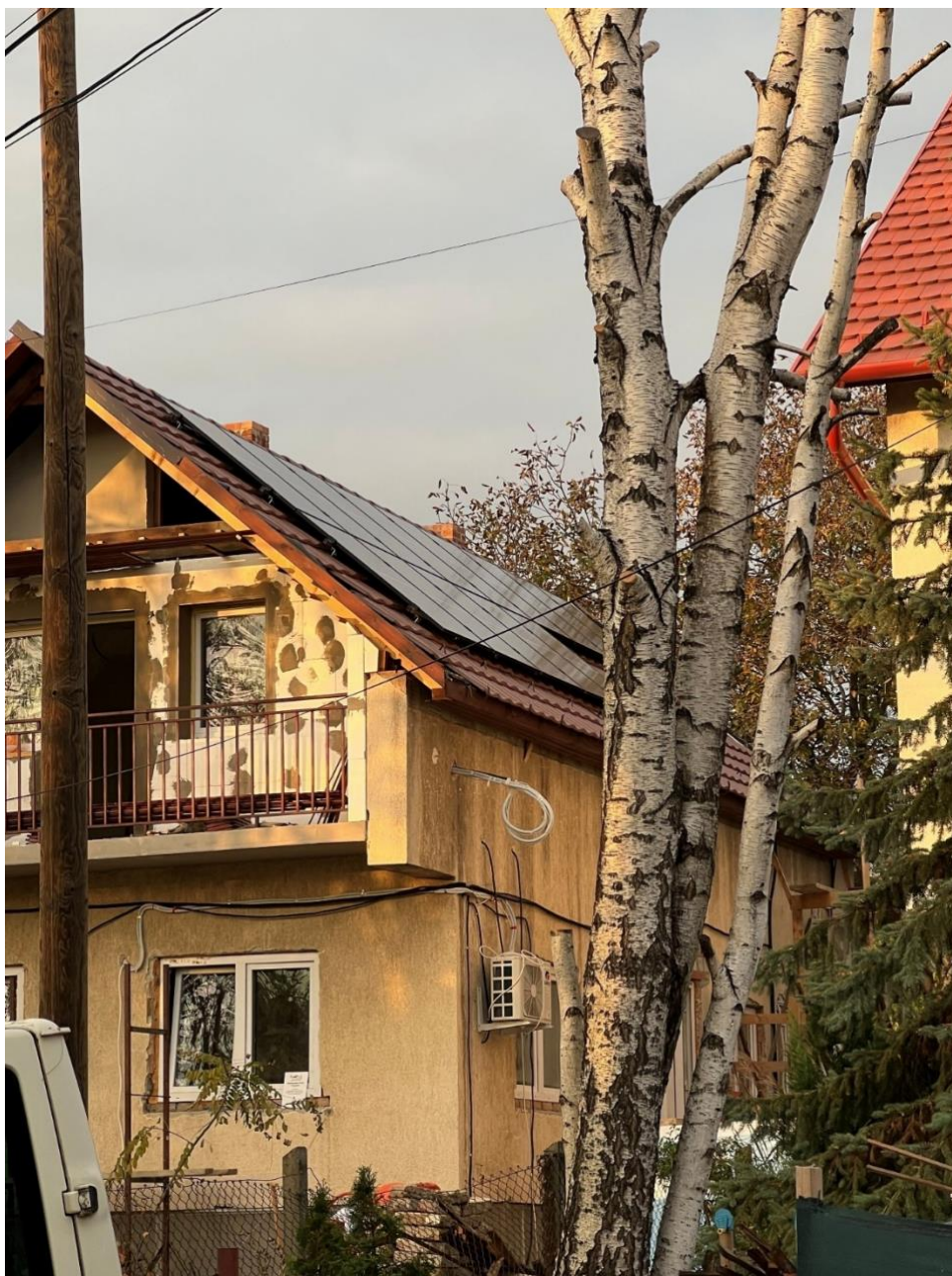
24. ábra: megvalósult napelemes rendszer
