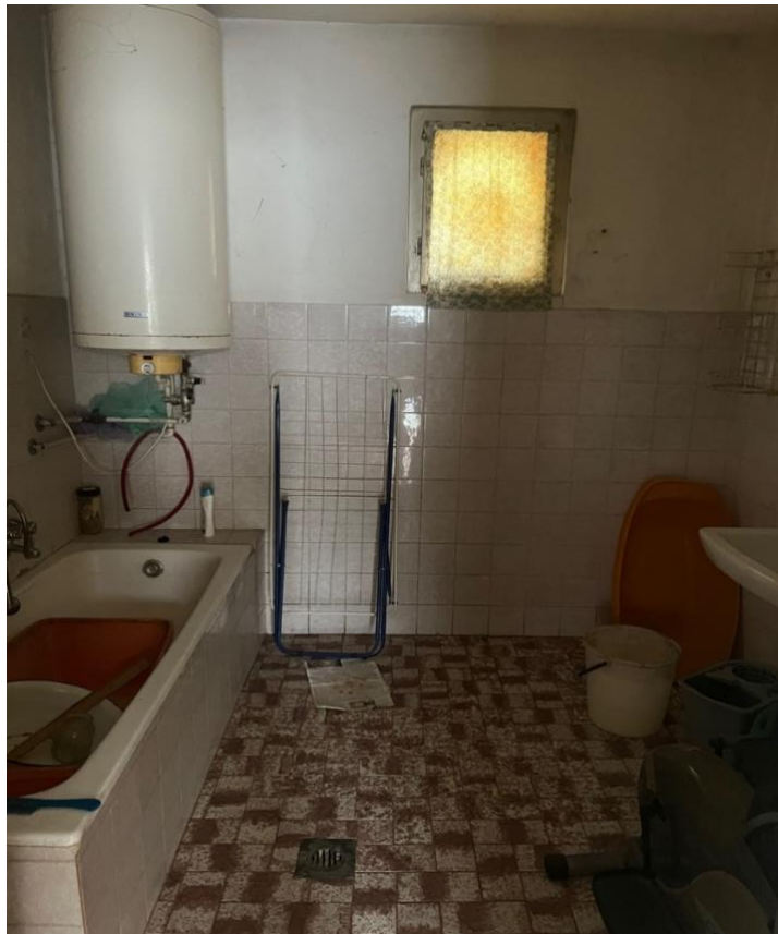
6. ábra: Hajdú villanybojler horganyzott vízvezeték csövekkel
