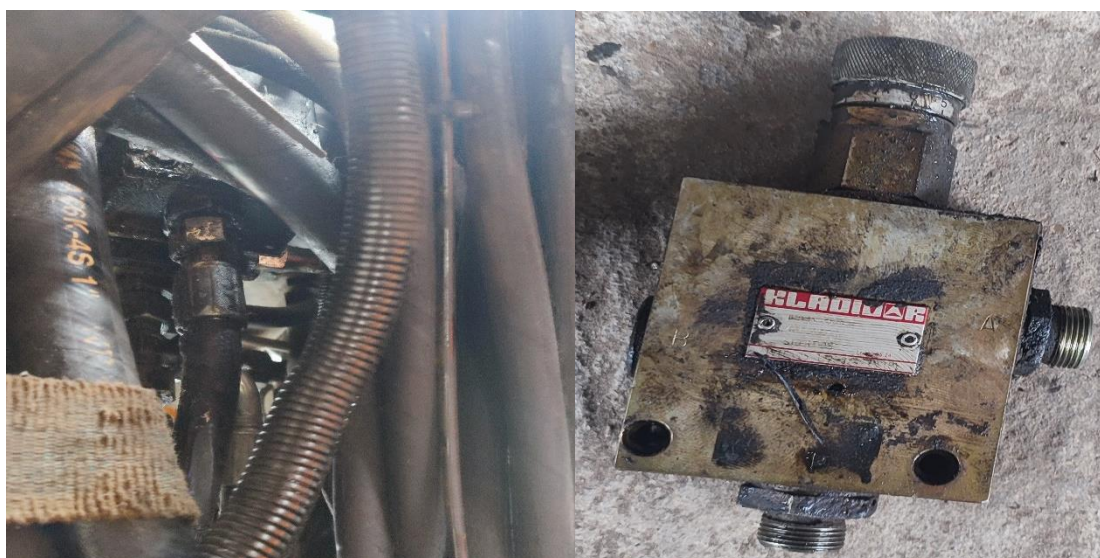
36. Ábra. Defektes hidraulikus nyomás szabályzó szelep.
