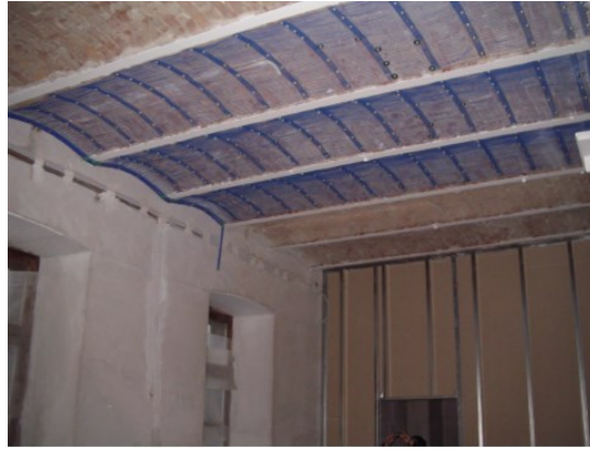
22.ábra Mennyezetfűtési-hűtési rendszer kialakítása a valóságban (Fűtéstechnika órai diasor: Gergely Dániel Zoltán)
