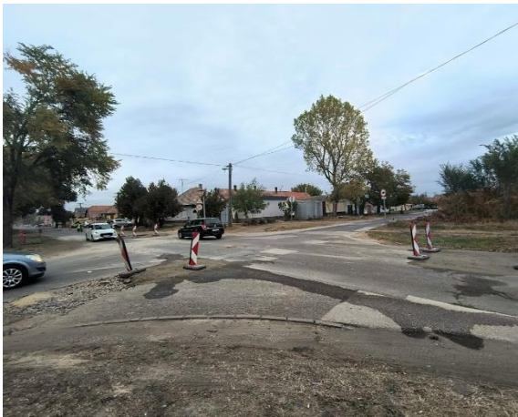
15. melléklet Útburkolat-rongálódás (Forrás: Saját kép, 2025.)
