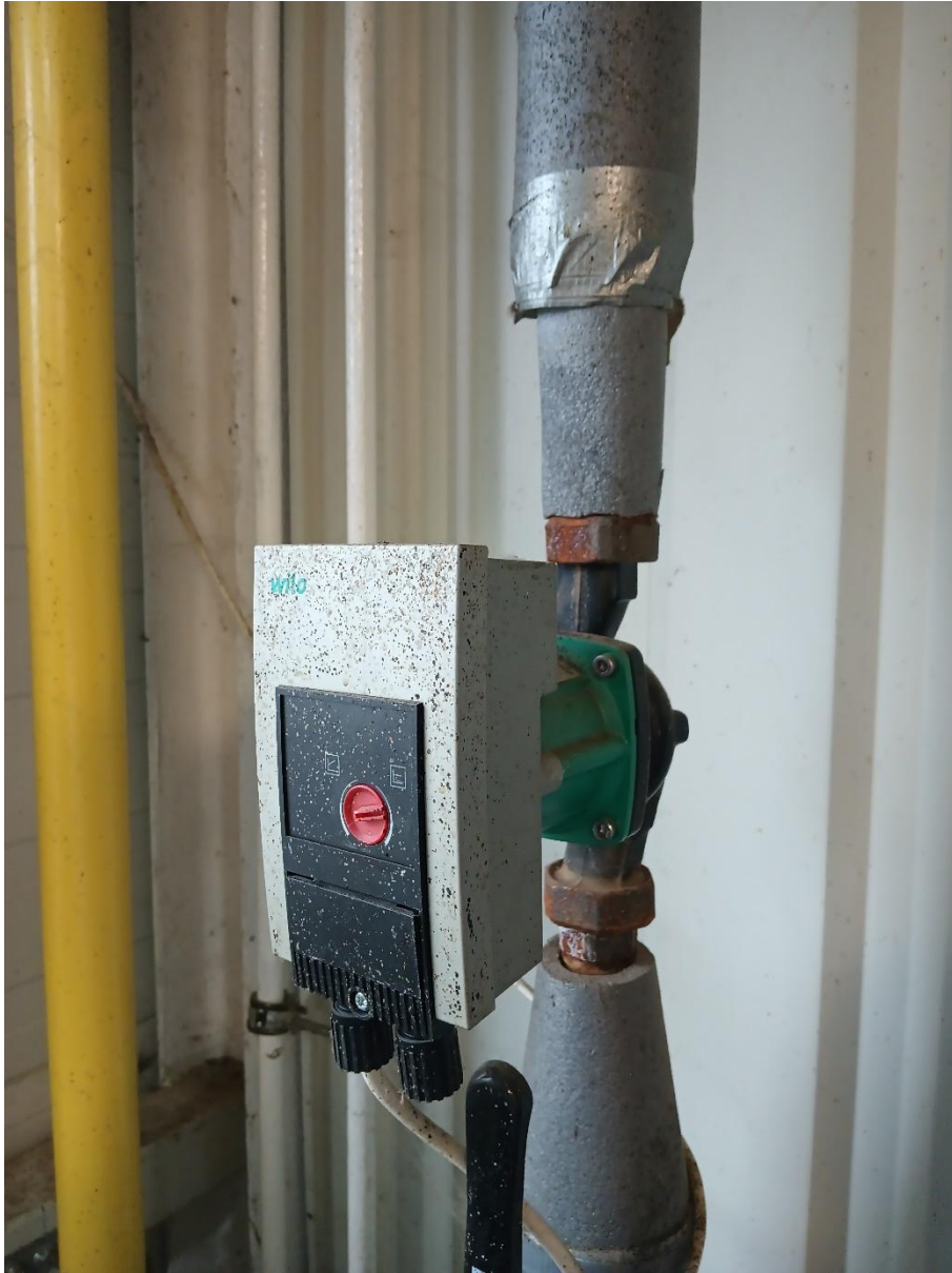
31. ábra Csőtisztításhoz tartozó keringető szivattyú indirekt melegvíz előállításához
