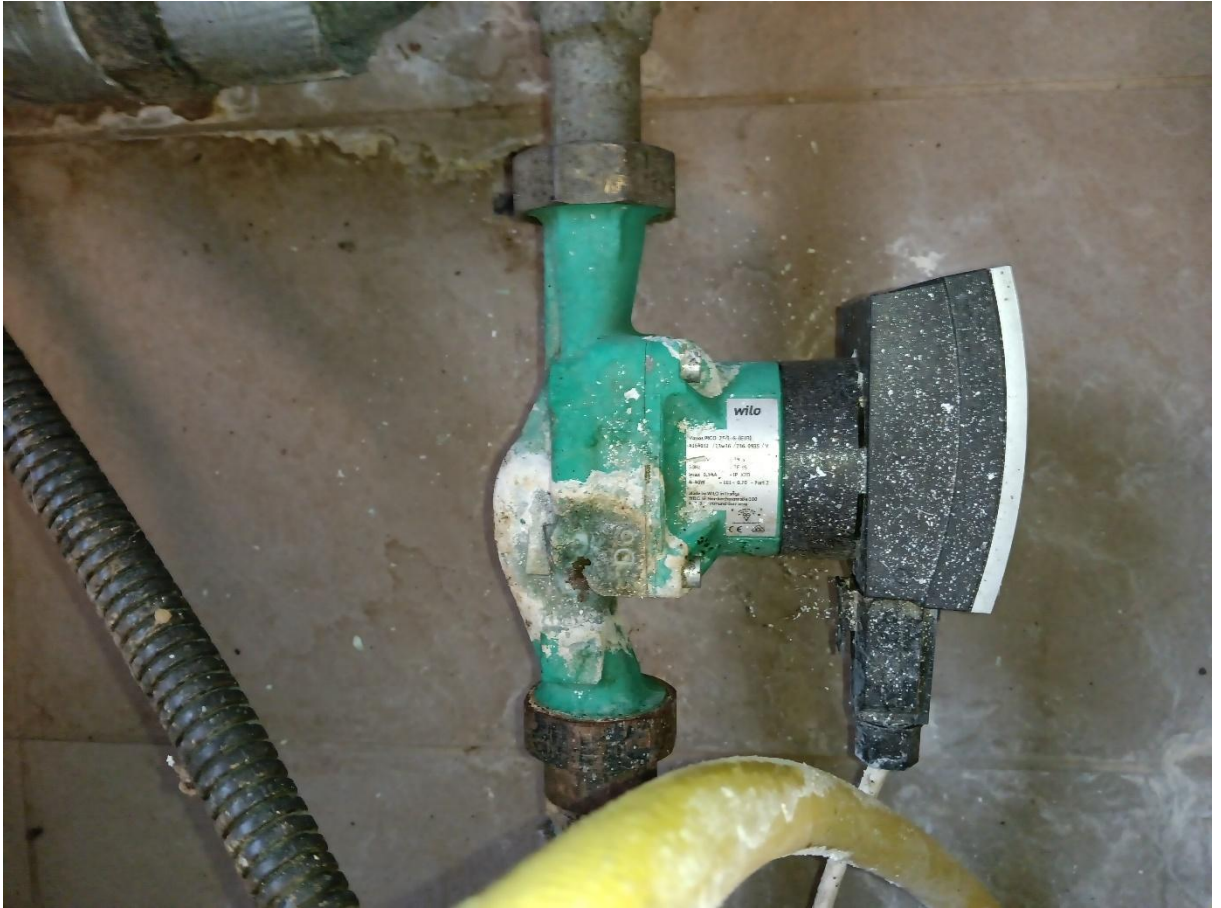
32. ábra Hibásan beépített HMV cirkulációs szivattyú ( a képen egy fűtési keringető szivattyú van)
