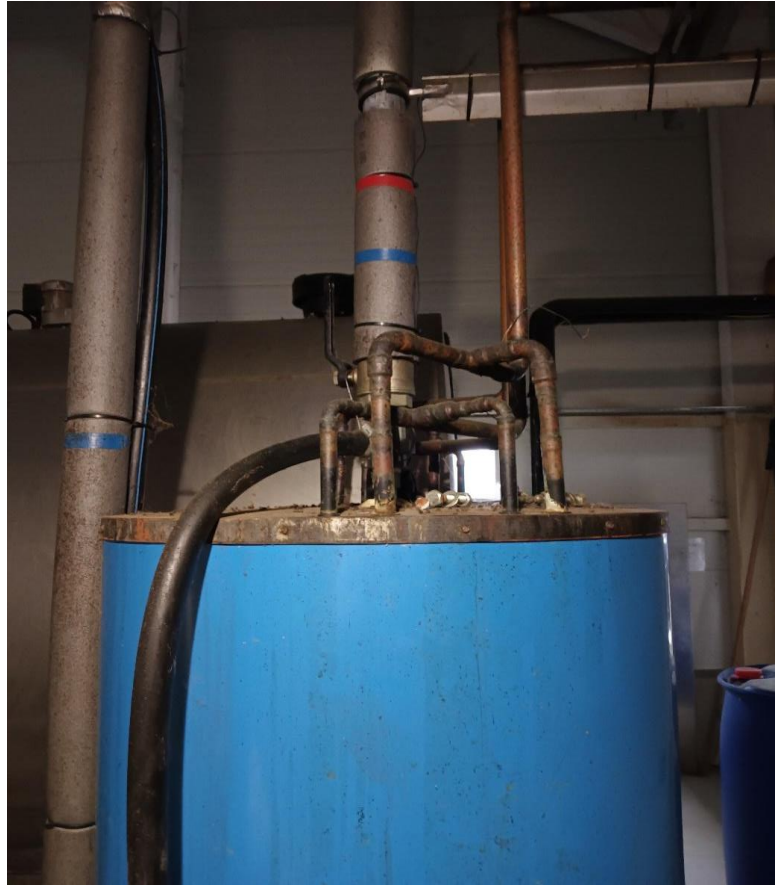
89. ábra Tejhűtő desuperheater tárolója
