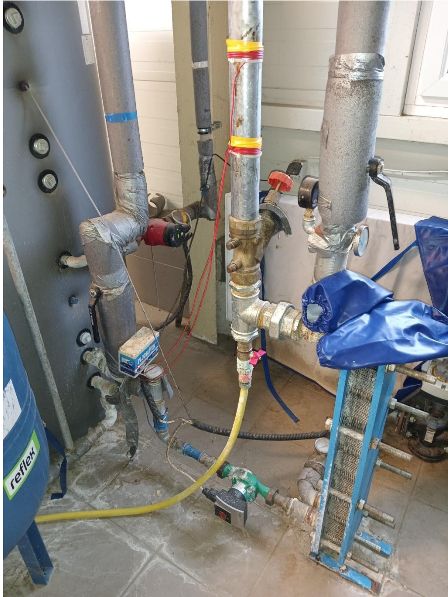
33. ábra Hibásan beépített szivattyú (lent)
