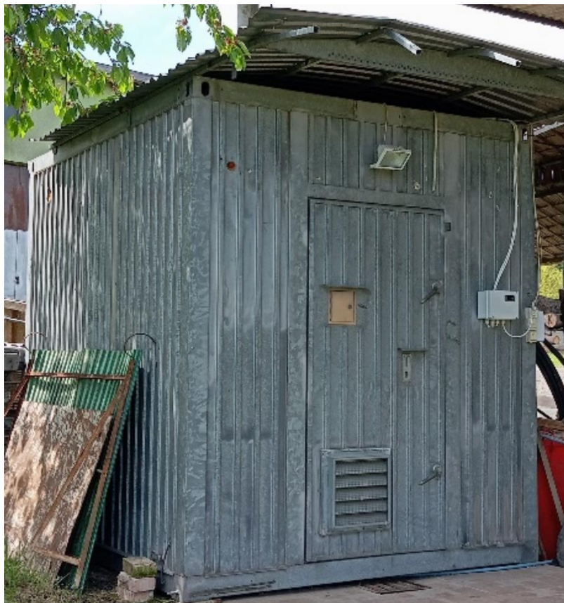
19. ábra - A hűtőkamra (Saját forrás)
