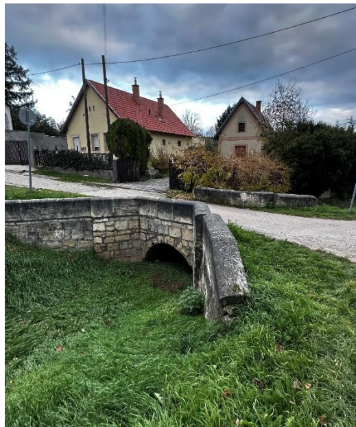
38. ábra: Rácváros utca 12.sz. előtti híd (Saját fénykép, Zsámbék, 2024.11.15.)
